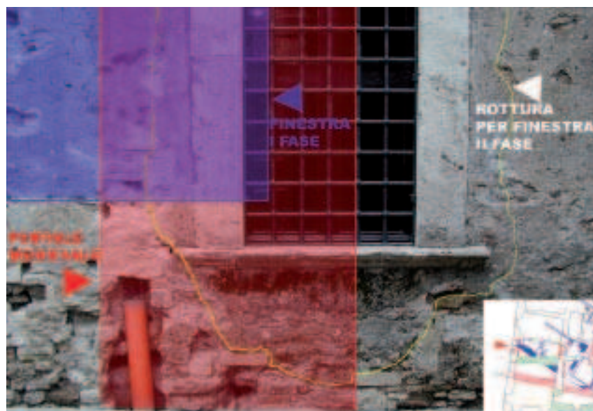
Fig. 14. Una mappatura di fasi lungo la facciata orientale, che affaccia sul giardino segreto.
