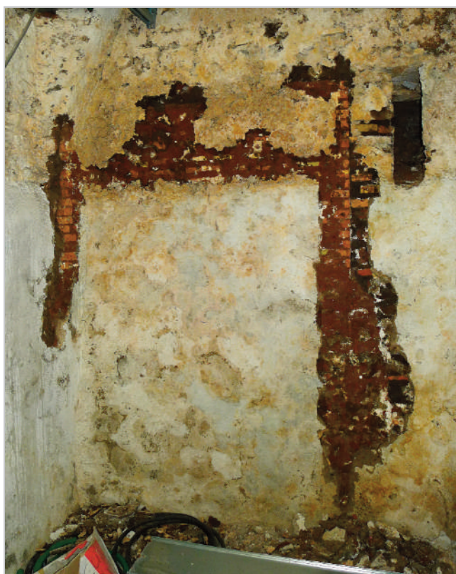
27. ROMA. TRINITÀ DEI MONTI. LOCALE K1 SOTTO LA PORTINERIA. ANGOLO N-O, VISTA E. PILASTRO IN LATEROZI INGLOBATO NELLA PARETE CINQUECENTESCA. SULLA SIN., SOTTO L'INTONACO DELLA PARETE NORD SI SCORGE IL FILO DELLA FACCIATA OCCIDENTALE DEL PILASTRO, SCALPELLATA VIA PARZIALMENTE PER TIRARE UN UNICO MURO DI FONDO DELL'AMBIENTE
