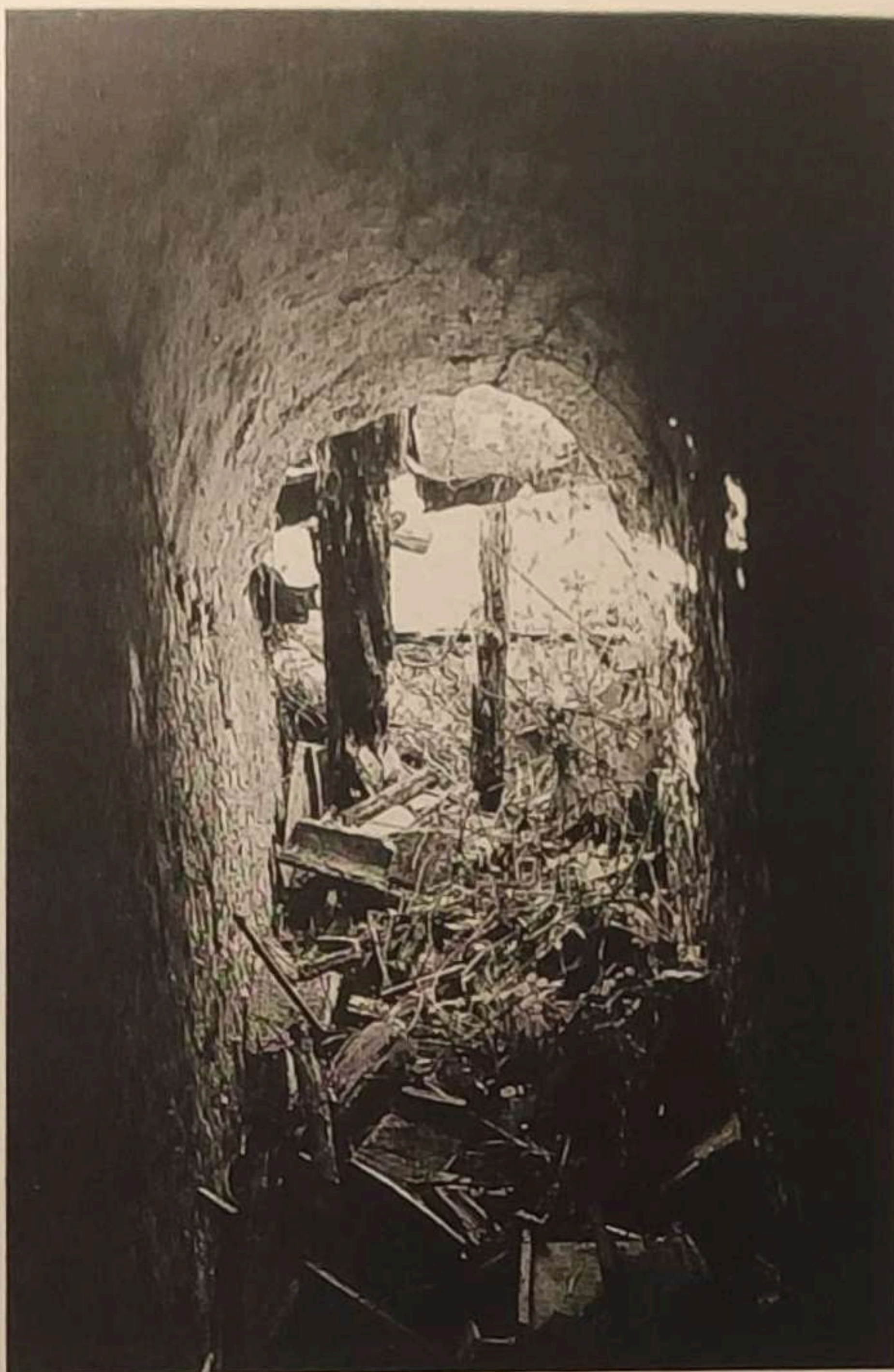
Fig. 20. Corridoio/intercapedine: resti del crollo della costruzione moderna soprastante.
